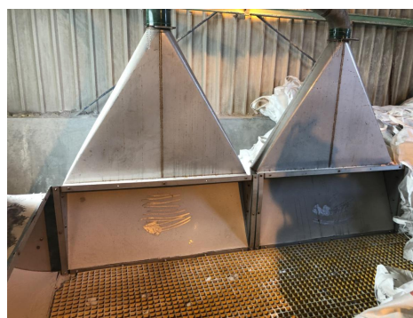
3-7 西侧拆包间上料口
